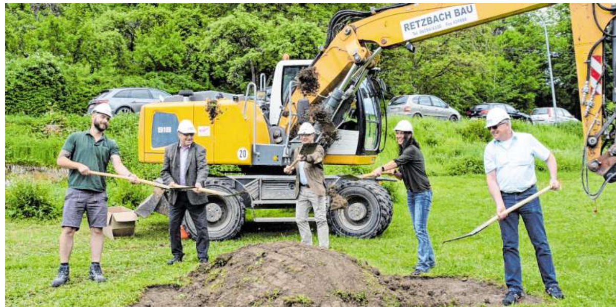
Bürgermeister Andreas Köhler (Mitte) beim Spatenstich der neuen „Kita Ginsbachtal“. Mit dabei waren auch Ortsvorsteher Werner Rückgauer (Zweiter von links) und Architektin Margit Munz.
